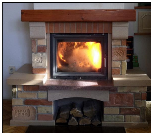
1. kép. Kandallóban égő és előkészített fahasábok /Fotó: Móró Kandalló/
